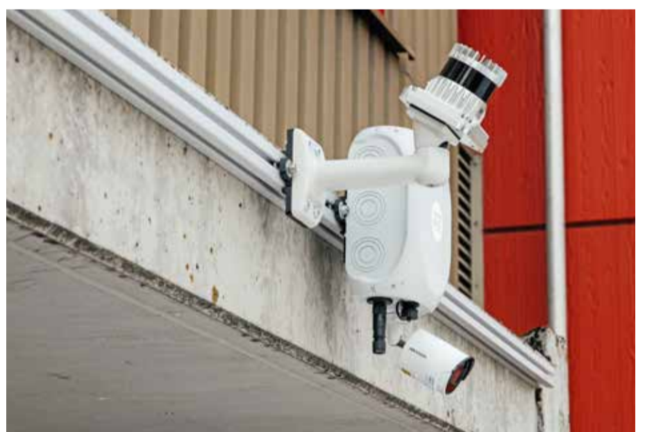
An zwei Ladetoren installierte Kameras übertragen Daten über das 5G-Campusnetz.
