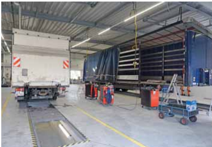
Hinter den sechs Toren verbergen sich bei TIP in Schwieberdingen drei Gruben, um die nötigen Arbeiten an den Fahrzeugen auszuführen.
